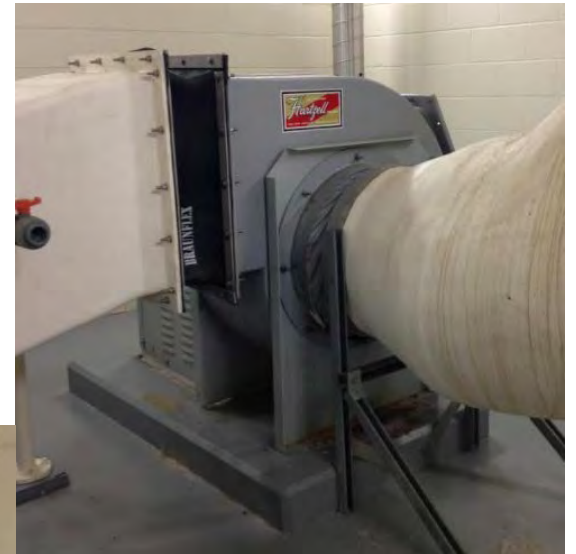
Biosolids scrubber fan
