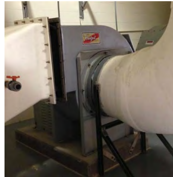
BAF scrubber fan
